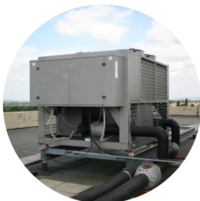
سیستم‌های هواساز و چیلرها
